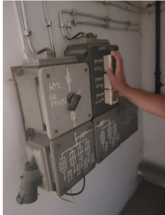
Zdj. 5. Szafa elektryczna kotłowni
