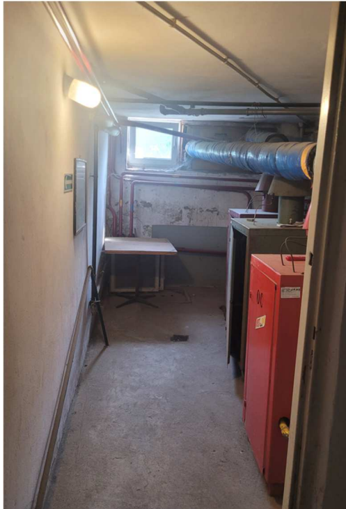
Zdj. 4. Pomieszczenie kotłowni gazowej
