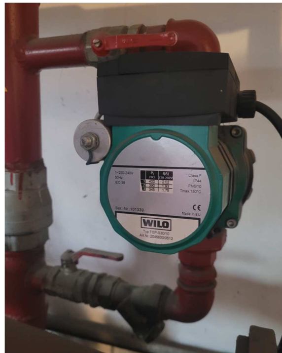
Zdj. 7. Pompa obiegowa nr 2
