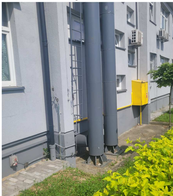
Zdj. 1. Podstawa kominów spalinowych i szafka gazowa
