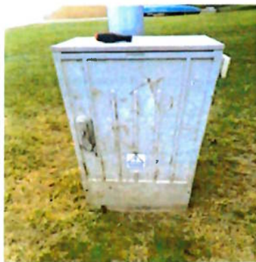
Zdjęcia rozdzielni elektrycznej
